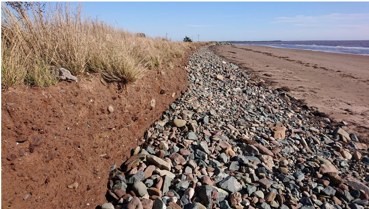
Figure 7. Accumulation de galets et de pierres devant l'ensablement à P17 en octobre 2023, vue vers l'est.
