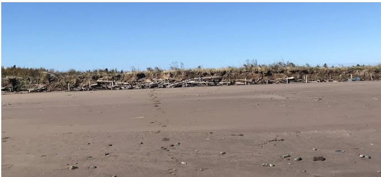
Figure 8. Photo de l'érosion à P14 en octobre 2023, vue nord à partir de la plage.
